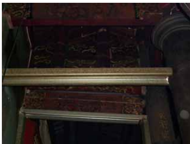
照片 2 樂成宮承重山牆與桁檁接合點應力破壞模式
