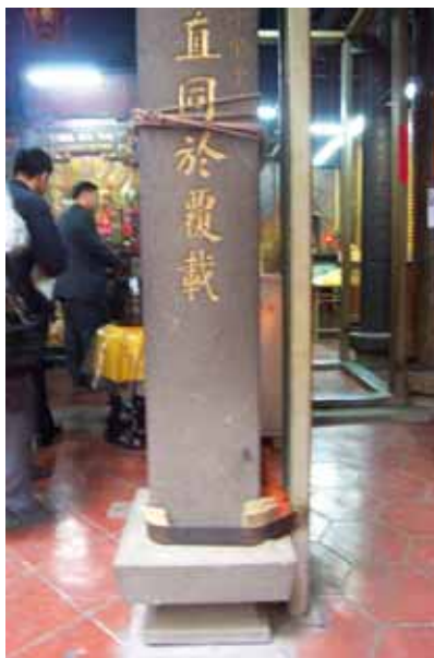
照片 5 樂成宮內部柱體產生側向移動
