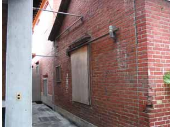
照片 4 樂成宮受到水平力影響導致角隅開裂現象
