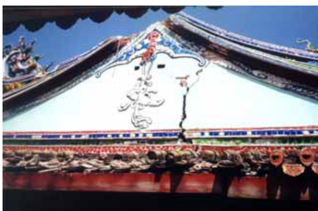
照片 3 樂成宮受到地震波之後的破壞
